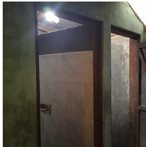
Gambar 12 Kamar Mandi 2 Ruang Utara
