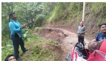
Gambar 1. 2 Jalan Terputus Akibat Tanah Longsor (Dokumentasi Peneliti, 2022)
